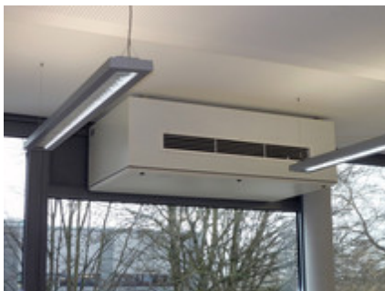
Die Variante mit den Deckengeräten überzeugte besonders im Hinblick auf die Luftdurchmischung und beim Einbauvolumen. © Ingenieurbüro Ruess & Grömmer
